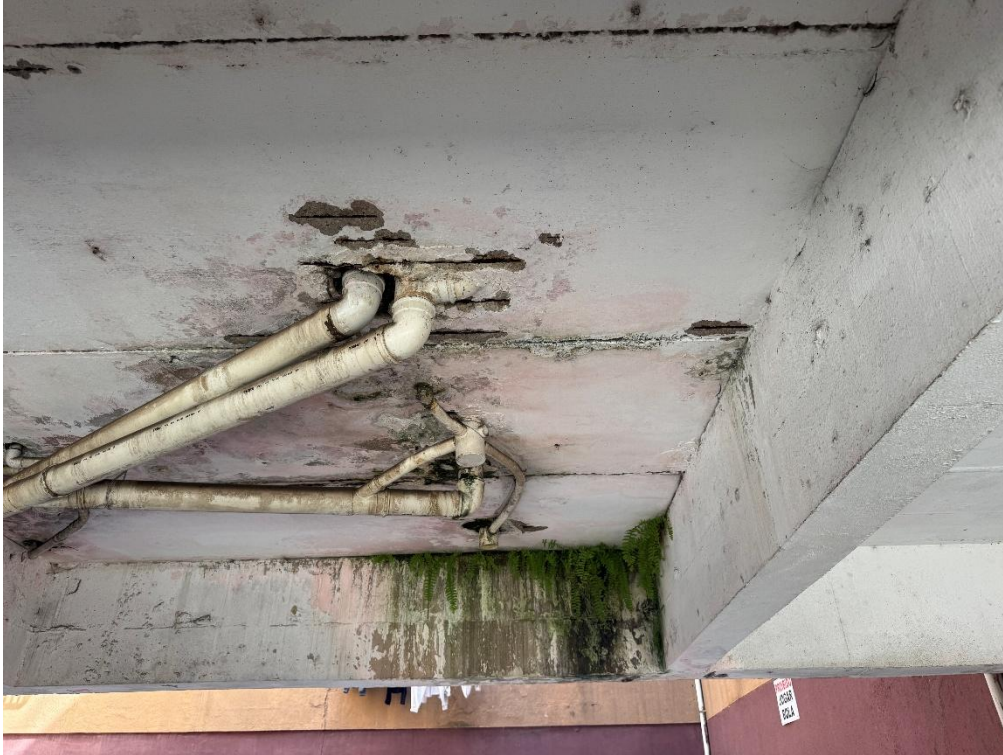
IMAGEM 4 SISTEMA HIDRÁULICO IMEDIATO E ABAIXO DO IMÓVEL IN LIDE APRESENTANDO SINAIS DE DEFLUÊNCIA HÍDRICA – (INFILTRAÇÃO)
