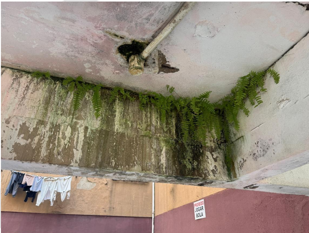
IMAGEM 5 PROLIFERAÇÃO DE VEGETAÇÃO EM ZONA LINDEIRO DO SISTEMA HIDRÁULICO IMEDIATO E ABAIXO DO IMÓVEL IN LIDE APRESENTANDO SINAIS DE DEFLUÊNCIA HÍDRICA – (INFILTRAÇÃO)
