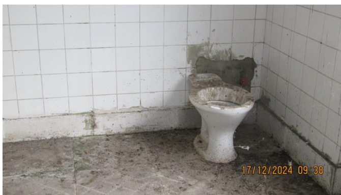
Foto 58 – Vista do banheiro do imóvel “B”.
