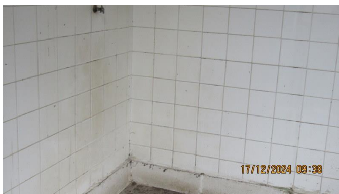
Foto 59 – Detalhes do revestimento do banheiro do imóvel “B”.
