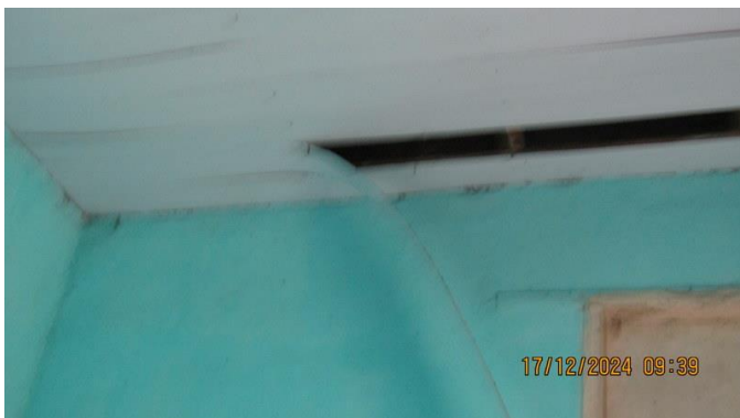
Foto 51 - Detalhes do forro do imóvel "B".
