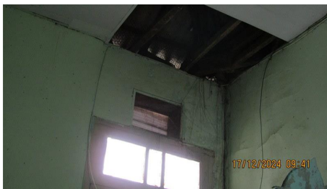
Foto 50 – Detalhes do forro do imóvel "B".
