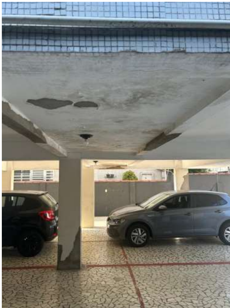
Foto 3 – Vista da garagem e de área atingida por vazamentos da unidade 12.
