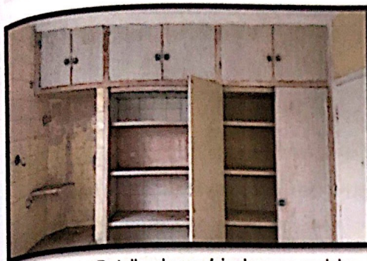
Foto 13 – Detalhe do armário da copa-cozinha, destaque para o estado de conservação.
