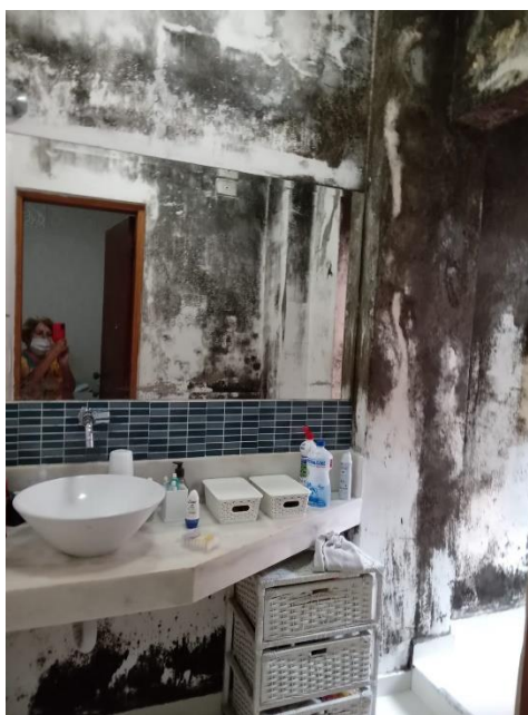
FOTO 10:- Vista banheiro do imóvel com infiltração
