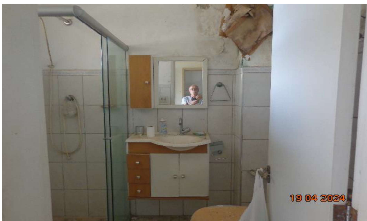
FOTO 4: Banheiro, com revestimento solto e caindo.
