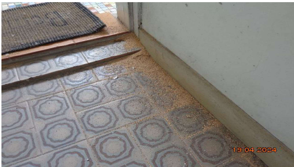
FOTO 2: Soleira da entrada, corroída por cupim.
