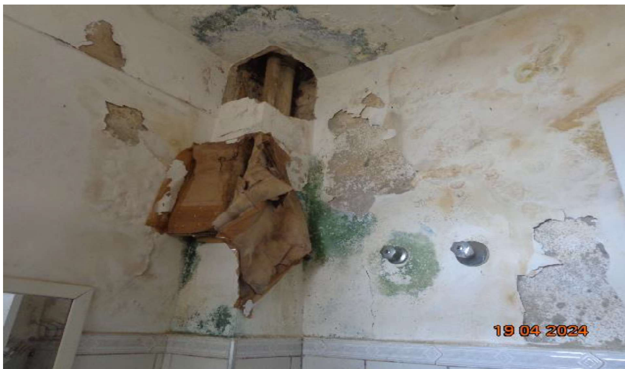
FOTO 5: Outra vista do banheiro com revestimento caindo e solto.
