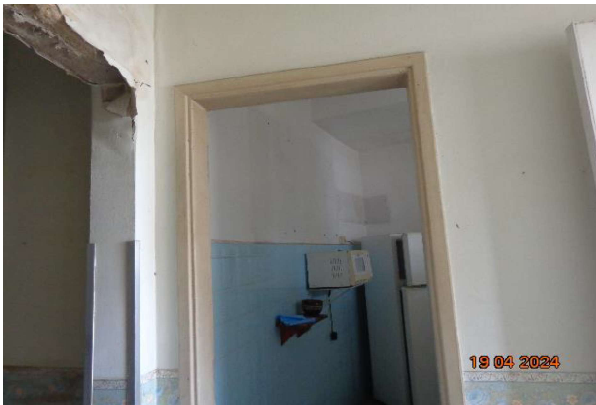
FOTO 7: Vista do hall de acesso à cozinha e sala. Soleira da sala, caindo.
