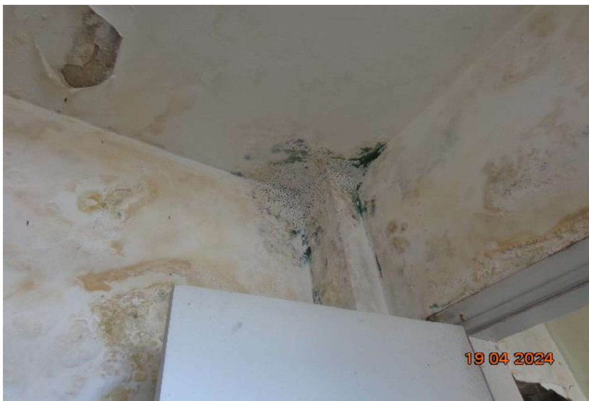
FOTO 6: Outra vista do banheiro com revestimento solto e caindo.
