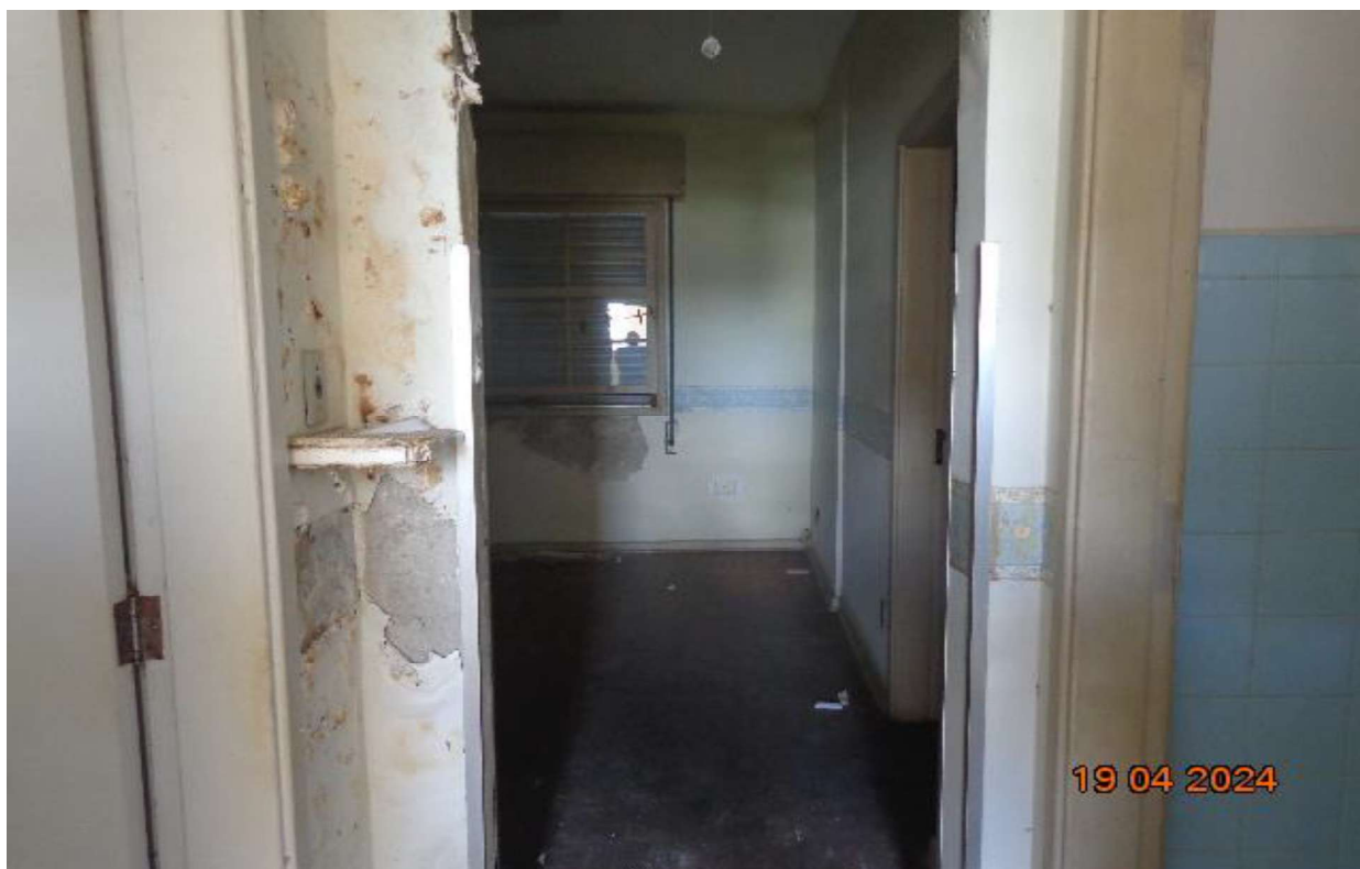
FOTO 3: Hall de entrada, com acesso à sala, cozinha e banheiro. Revestimento solto.
