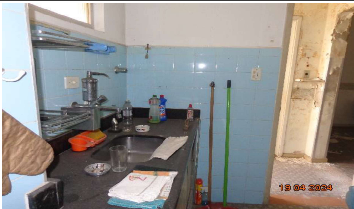
FOTO 9: Outra vista da cozinha. Vista do hall, com revestimento solto.
