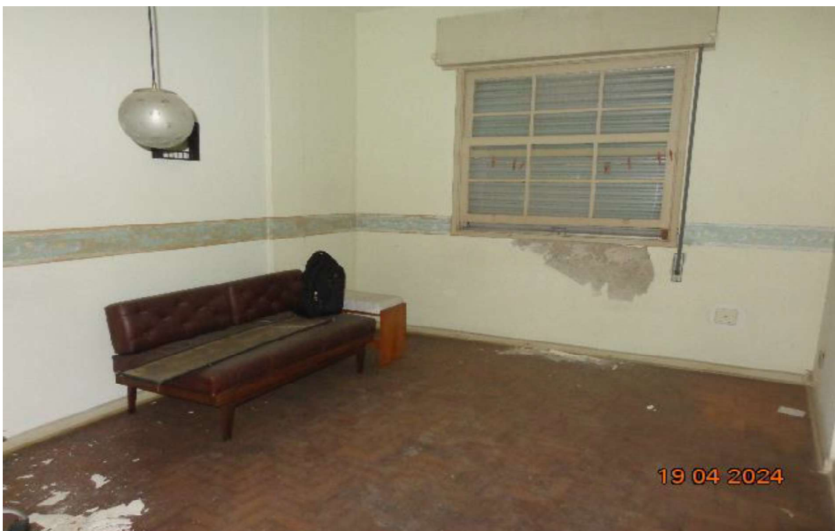
FOTO 11: Vista da sala, com revestimento sob janela, solto.
