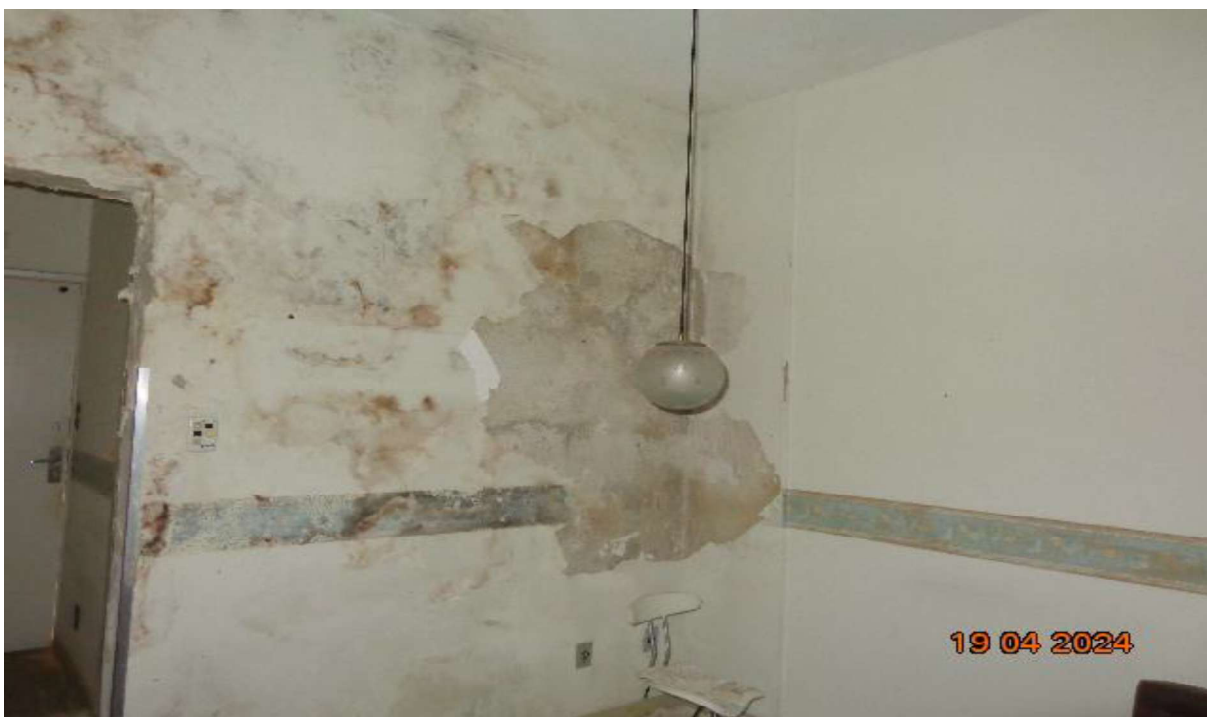
FOTO 12: Parede da sala, divisa com banheiro. Revestimento solto e caindo.
