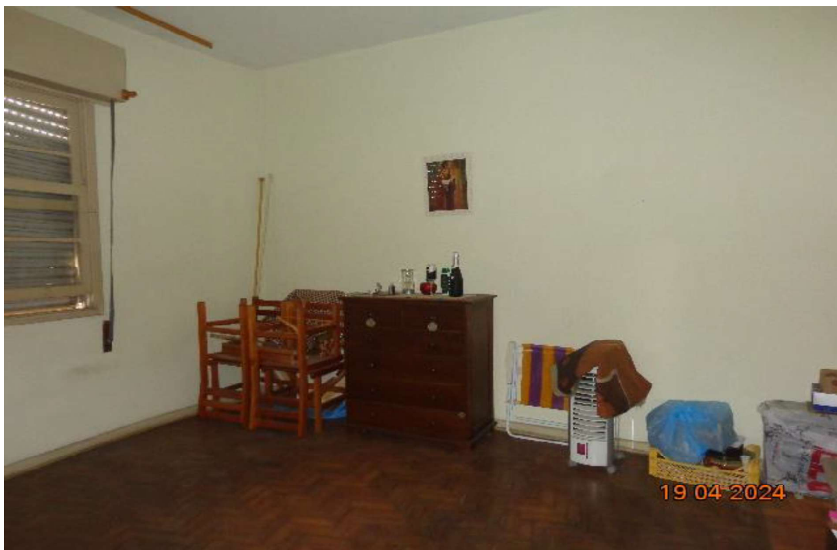
FOTO 13: Vista do quarto. Janela emperrada.
