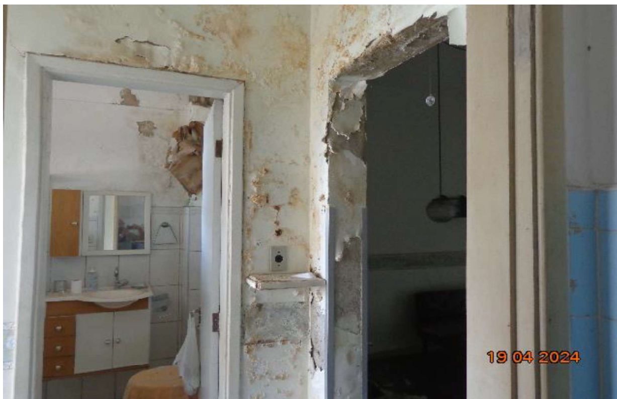
FOTO 10: Vista do hall, com acesso ao banheiro e sala. Revestimento solto.
